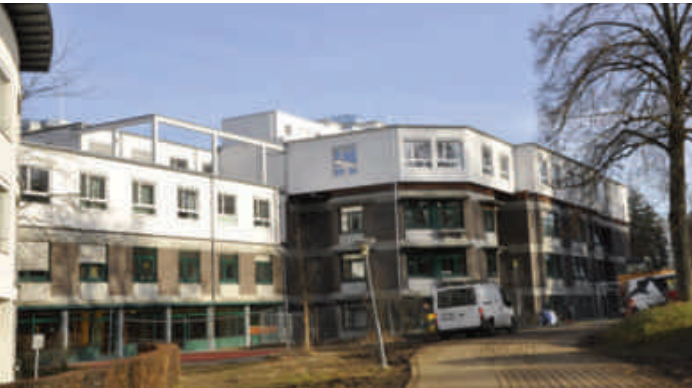
Rückansicht Haus 22: (v.l.n.r.) Aufstockung der oberen Etage des West- und des Ostflügels
